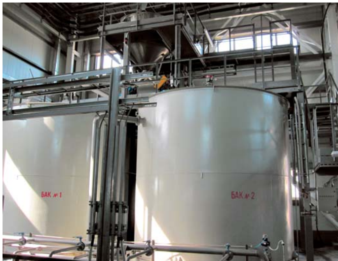
Установка приготовления и дозирования флокулянта
